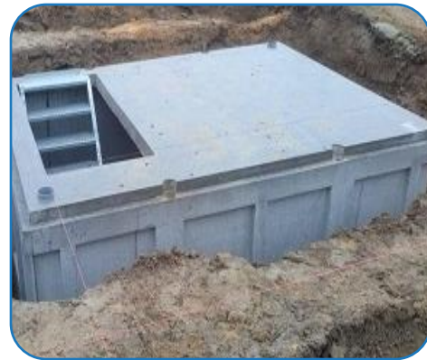
Cuve de stockage
